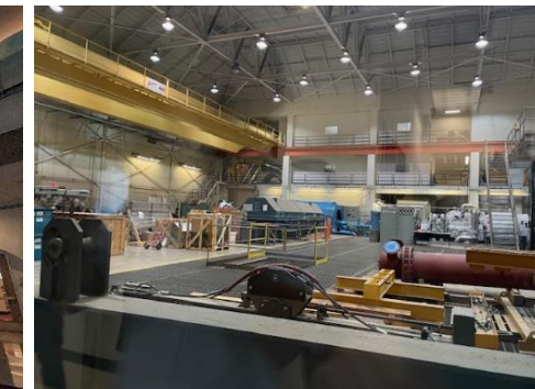
コジェネレーション発電施設
