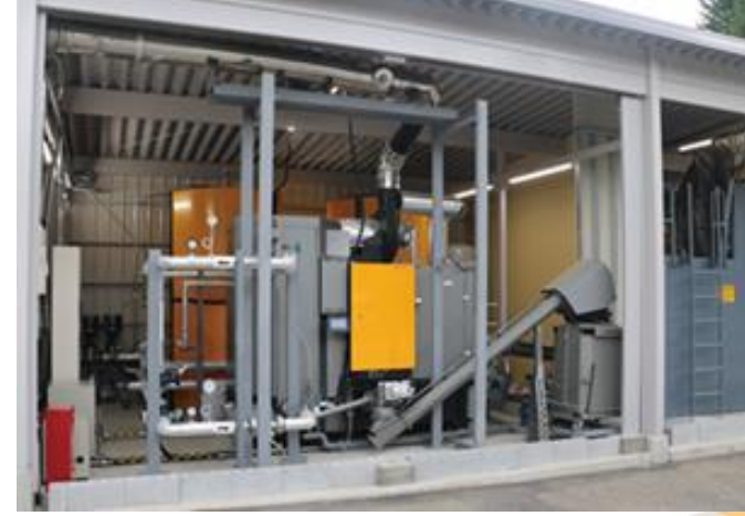
③木質バイオマスボイラー
